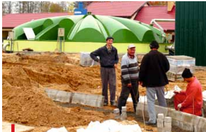
Zbiornik fermentacyjny oczyszczalni ścieków przyciąga wzrok swoim niesamowitym kształtem
