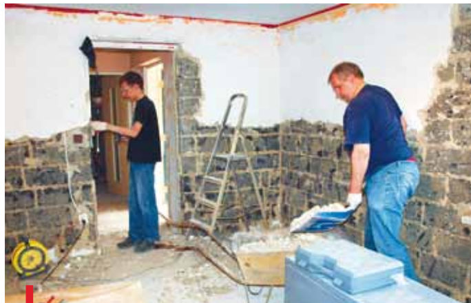
Większość zalanych podczas powodzi domów wymaga kosztownego remontu i wyposażenia
