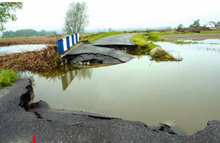
Droga z Turza do Rudy przy moście została zerwana. Mieszkańcy jeżdżą teraz drogą okrężną
