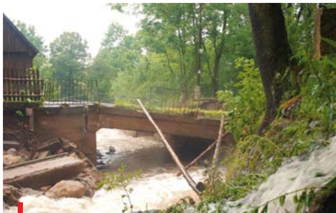
W Strużnicy woda zniszczyła most na głównej drodze, odcinając część wsi od świata
