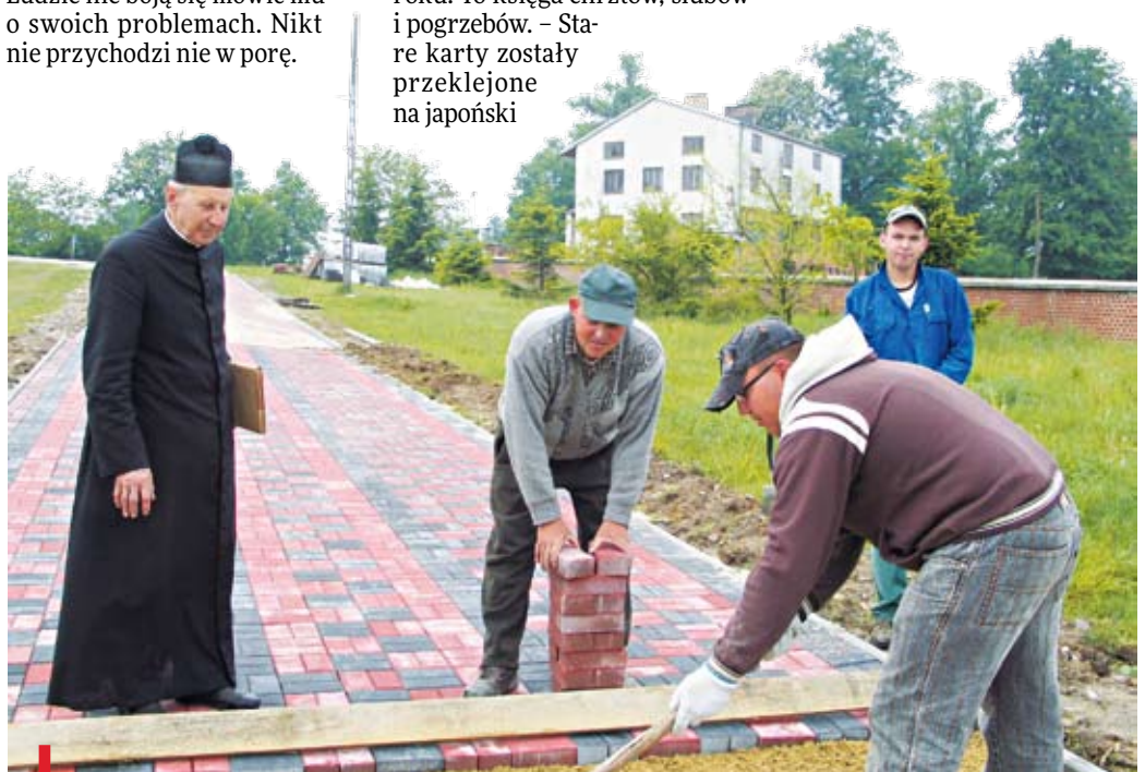
Praca wre. Tak jest zawsze. Tym razem powstaje nowa nawierzchnia na drodze na cmentarzu
