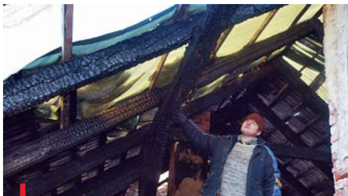
Podczas pożaru spłonął dach nad wszystkimi pomieszczeniami
