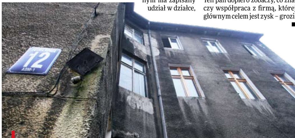
Najprawdopodobniej kamienica zostanie wyburzona, a ziemia sprzedana
