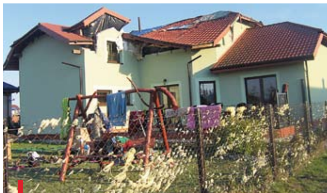
Ofiarom trąby powietrznej diecezjalna Caritas przekazała już 230 tys. zł. Na zdjęciu zniszczony dom w Kalinie
