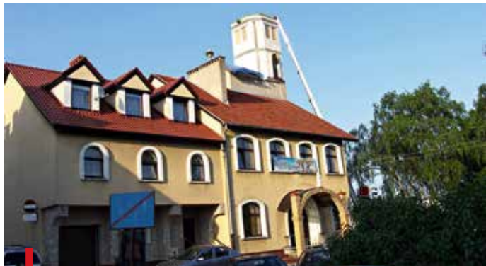
Wieża nadal w budowie, ale już niedługo biciem dzwonu będzie zapraszała wiernych na Mszę św.
