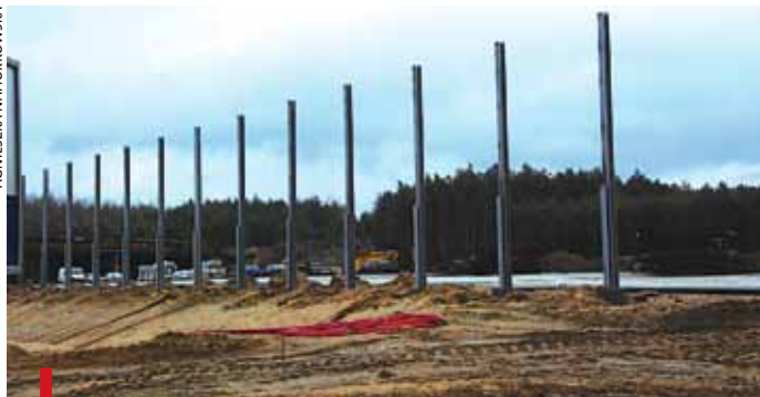
Na budowanych odcinkach autostrad A-1 i A-2 po ataku mrozu zauważono wiele usterek
