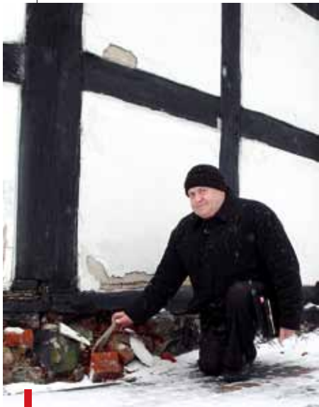
Pan Ryszard z troską ogląda kolejne ubytki w murach kościoła
