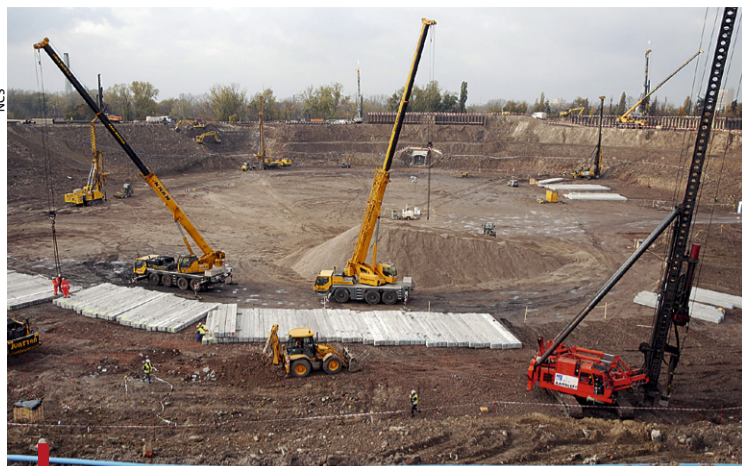
Żeby rozebrać stary stadion, trzeba było wywieźć 450 tys. m sześć. ziemi i umocnić grunt 16 tysiącami pali
