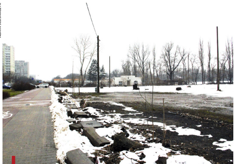
Plac budowy nieopodal klubu Stodoła (naprzeciwko MSW) jest już uprzętnięty. Rozstrzyga się przetarg na wykonawcę obiektu
