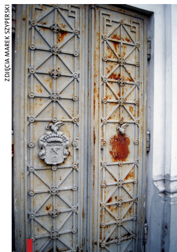
Wyraźnie skorodowane drzwi, na których widnieje herb rodu Krasińskich, prowadzą do krypty pod kościołem
