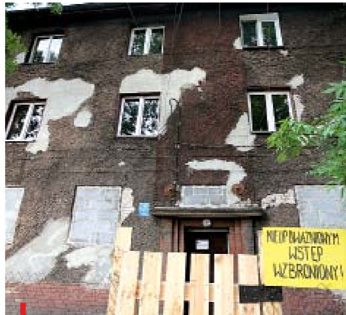
Pojawiające się w ścianach pęknięcia i odchylenie od pionu budynków to efekt prowadzonego wydobycia węgla. Mieszkańcy w związku z zagrożeniem musieli opuścić swoje mieszkania i w oczekiwaniu na lokale zastępcze przenieść się tymczasowo do hosteli
