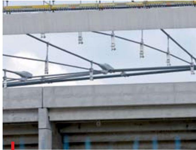
Uszkodzone elementy, tzw. krokodyle, łączące liny promieniowe z linami pierścienia rozciąganego zadaszenia Stadionu Śląskiego
