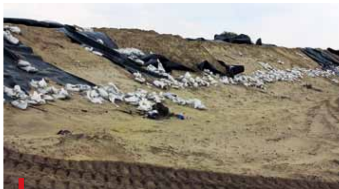
Ślady walki o utrzymanie tymczasowej opaski na wiślanym wale w Koćmierzowie wciąż są widoczne
