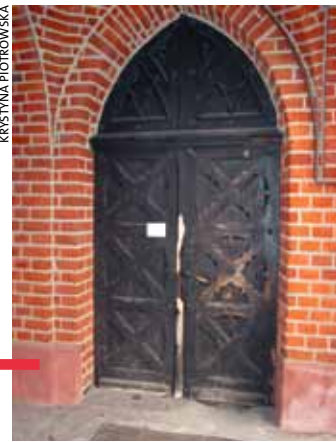
W wyniku próby włamania do świątyni zniszczono drzwi
